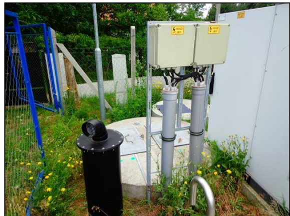
Átemelő akna kívülről
