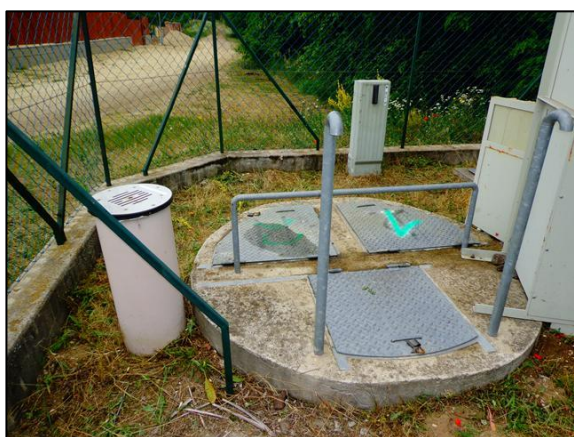
Átemelő akna kívülről
