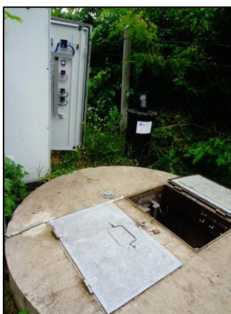
Átemelő akna kívülről
