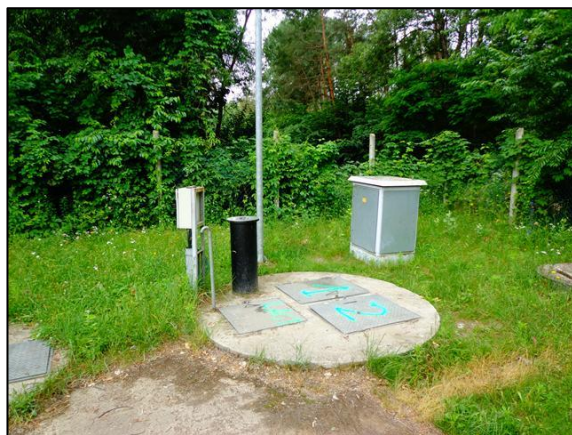
Átemelő akna kívülről
