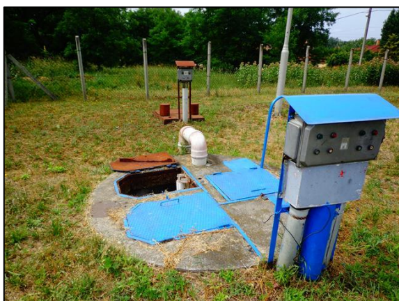
Átemelő akna kívülről
