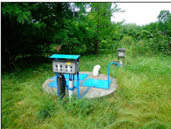
Átemelő akna kívülről
